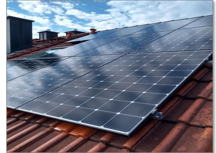
Bildquelle: Ingenieurbüro für Photovoltaik Dipl.- Ing. Klaus Nißl
